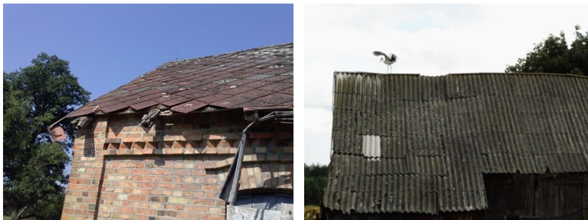
Rysunek 1. Pokrycia dachowe zawierające azbest: płyty płaskie (po lewej) oraz faliste (po prawej) [źródło: materiały własne]
